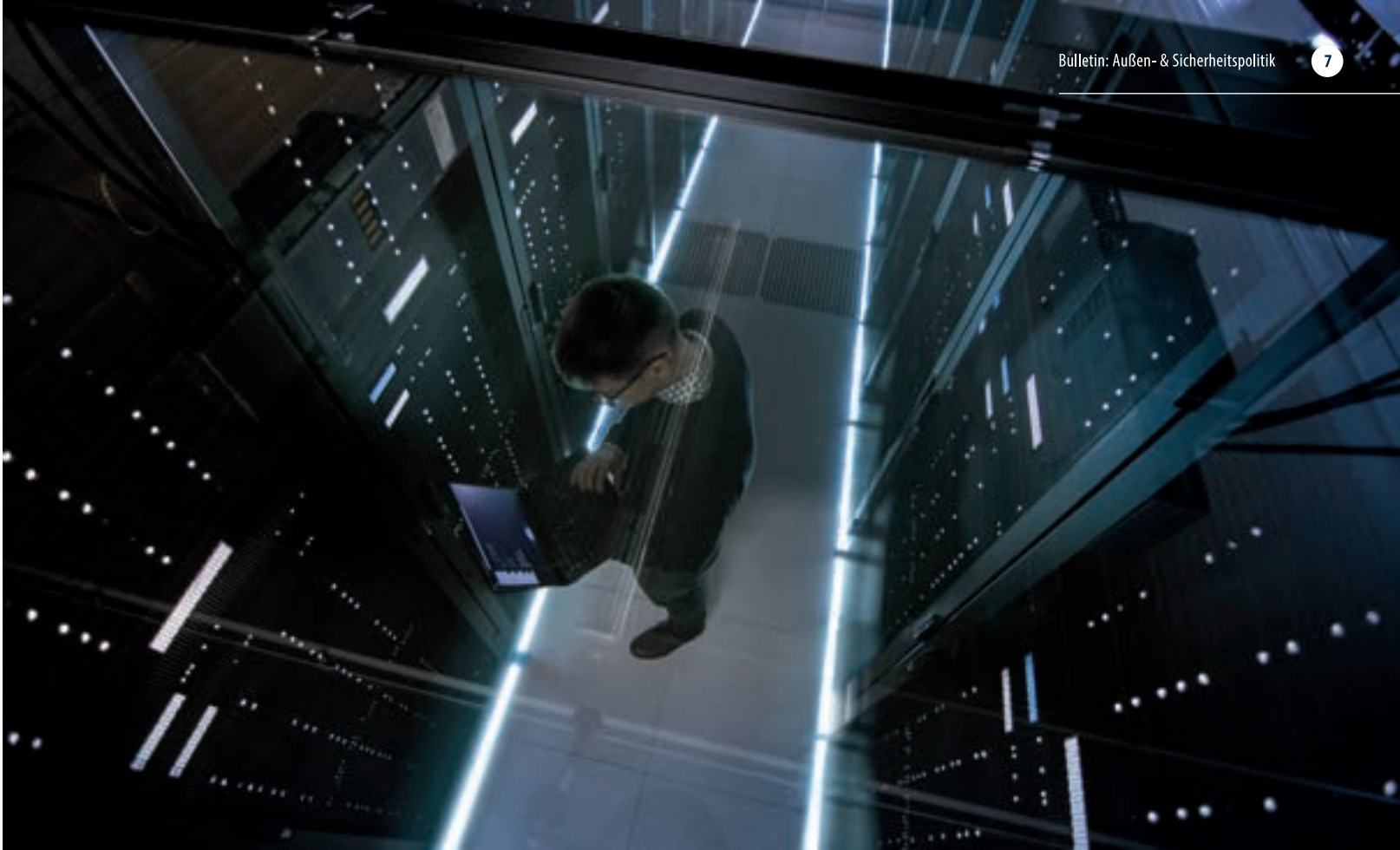
IT-Engineer in einem Rechenzentrum
